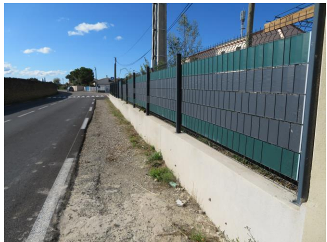
Clôture avec filet brise-vue
