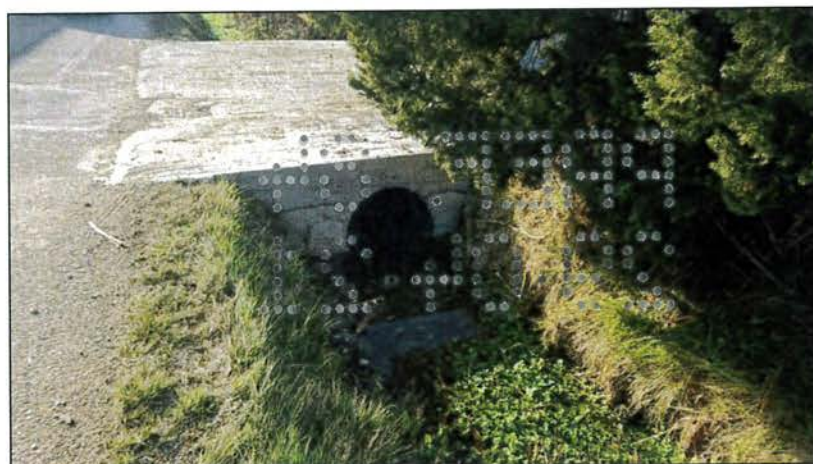
Figure 11 : Exemple d'ouvrage de franchissement à proscrire
